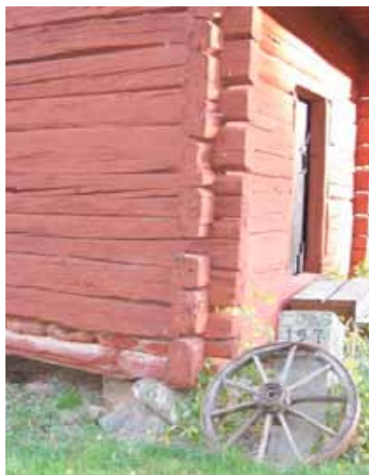
Portlidret i behov av renovering.
